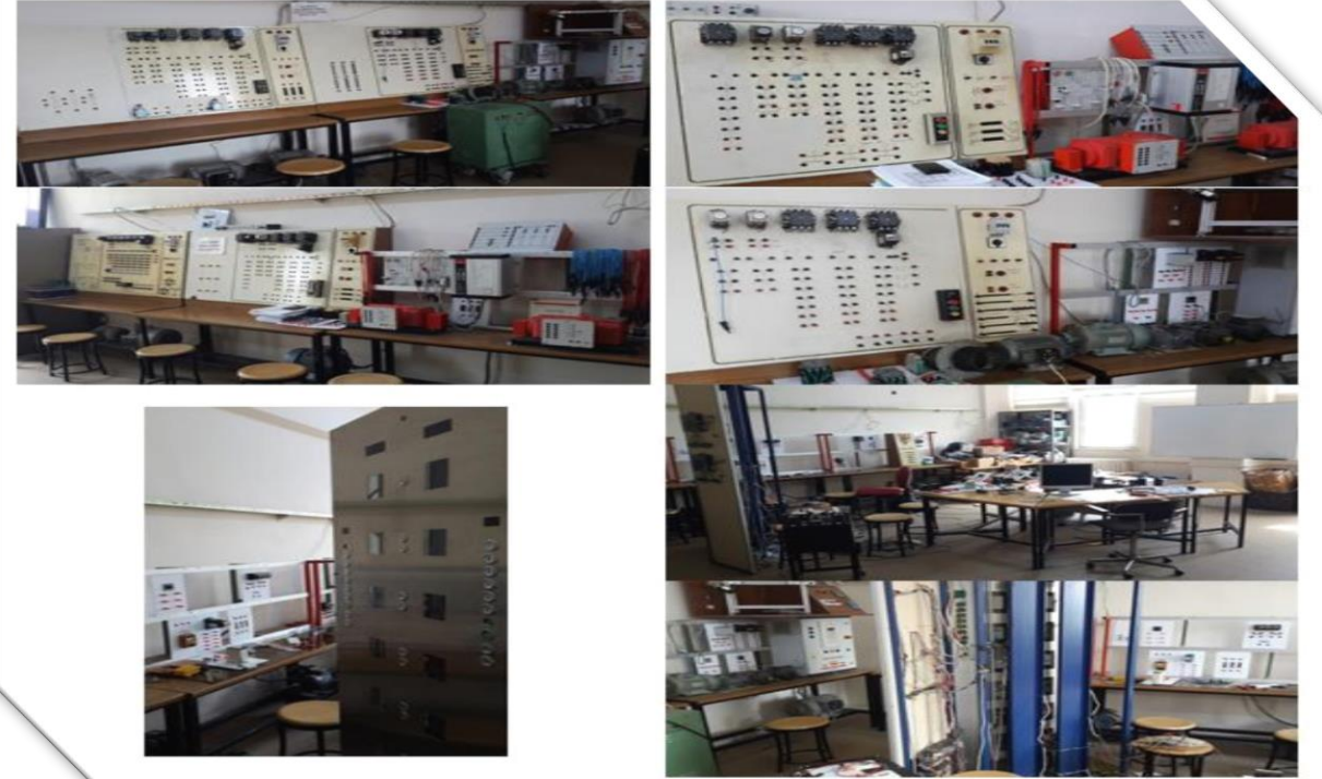
Elektrik Kumanda Laboratuvarı
